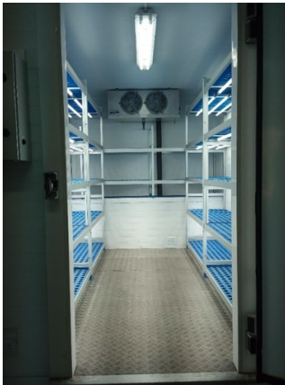
Interior cámara con estanterías y luces.
